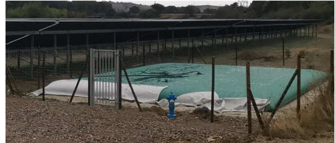
Photo 34 : Mise en place d'une citerne souple sur un projet ENOE (source : ENOE)
